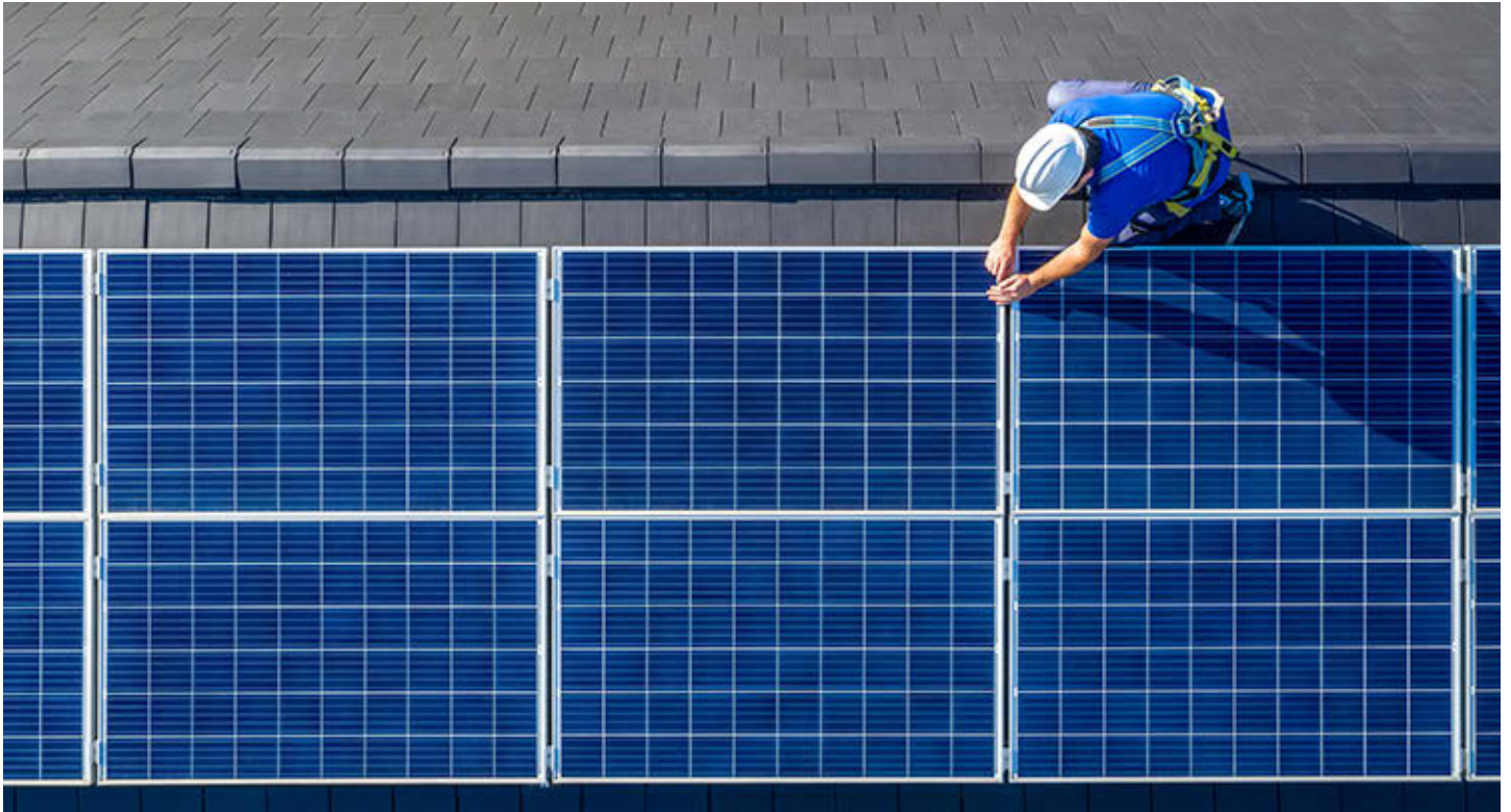
Algunas compañías de seguros exigen que la instalación la realice un técnico cualificado para cubrir las placas solares. istock
